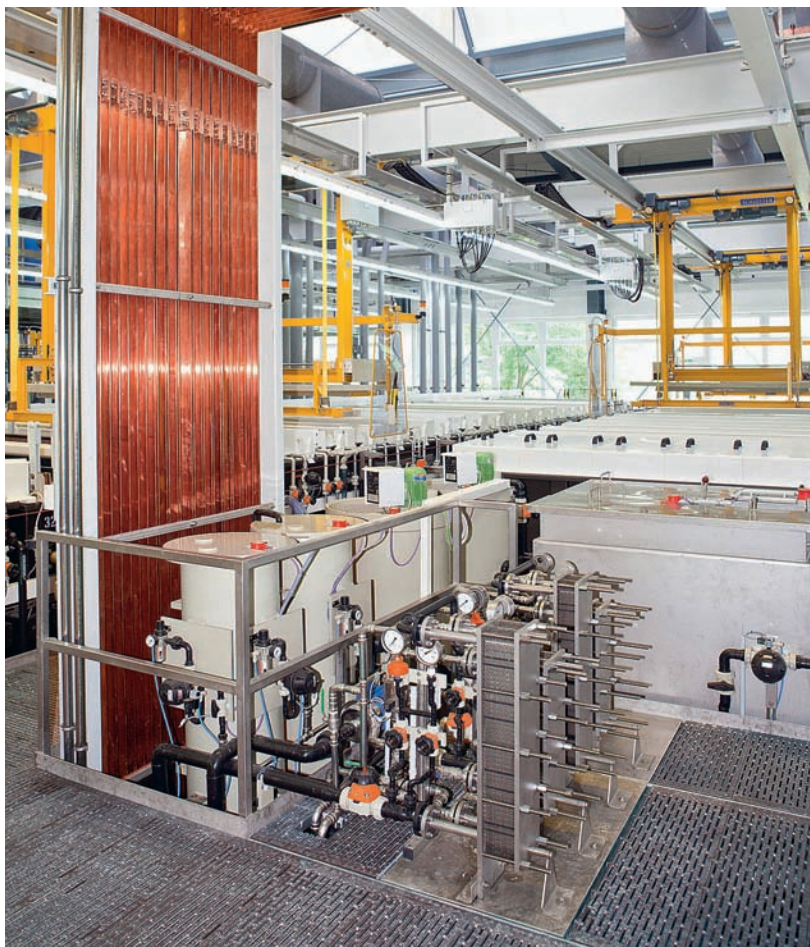
Teilansicht Galvanoautomat für Gestellartikel Partial view of automatic electroplating plant for rack items
